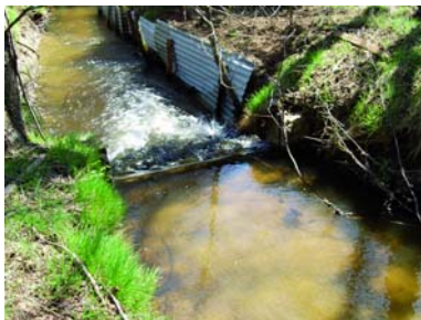
Protection de berge inadaptée
